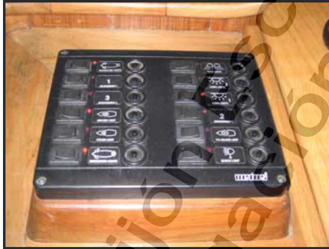
Cuadro de interruptores y fusibles.
